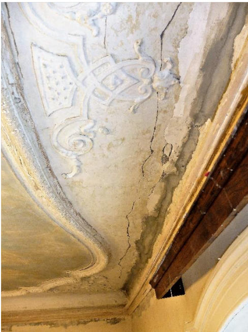
Sl.19 Pogled na strop gdje se nalazi injektirani ugao i pukotina koja se proteže uzdužno uz ugao na stropu.
