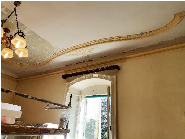
Sl.12 Dubinska pukotina uz ugao stropa i bočnog zida zatečeno stanje.
