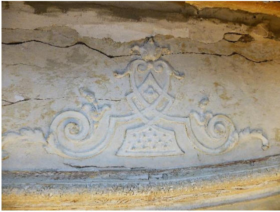
Sl.18 Površina zida na kojem se nalazi štukatura nakon otvaranja površinskih pukotina, u sloju fine žbuke.
