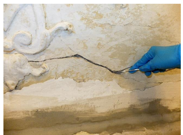
sl.17 Otvaranje pukotina
